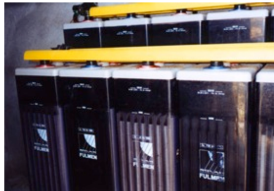
Parc de batteries / Crédit photo : SMA
